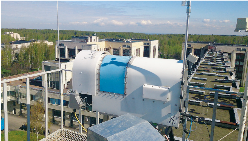
Рис. 1. Внешний вид аппаратуры RPG-HATPRO, установленной на крыше здания
